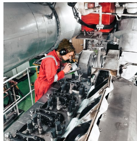
Fachkundig. Mit Kennerblick kontrolliert Schneider die Ventile im Hauptaggregat.
